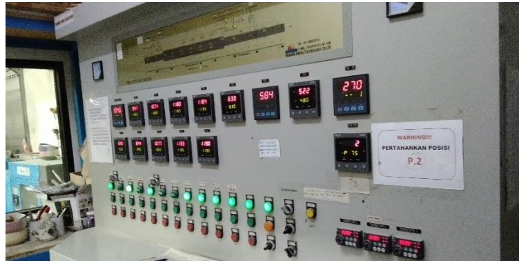
Gambar 5. Alat Kontrol Mesin Di Pabrik Keramik
