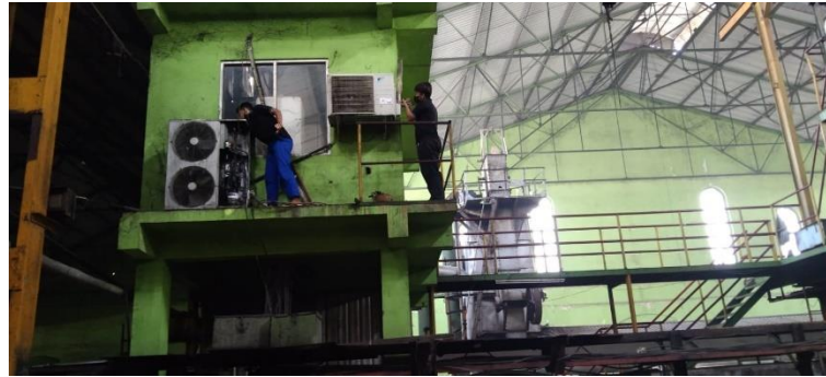
Gambar 3. Perbaikan AC Server Di Pabrik Gula Purwodadi
